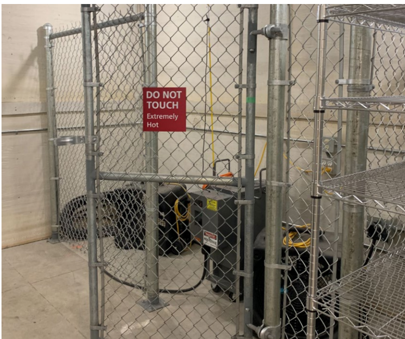
Figure 15: Salle de traitement thermique dans le bâtiment Cause We Care de la YWCA
